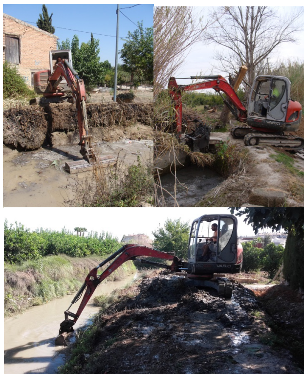
Figura 7. Actuciones de rehabilitación de pozas mediante dragado y retirada de residuos sólidos.
