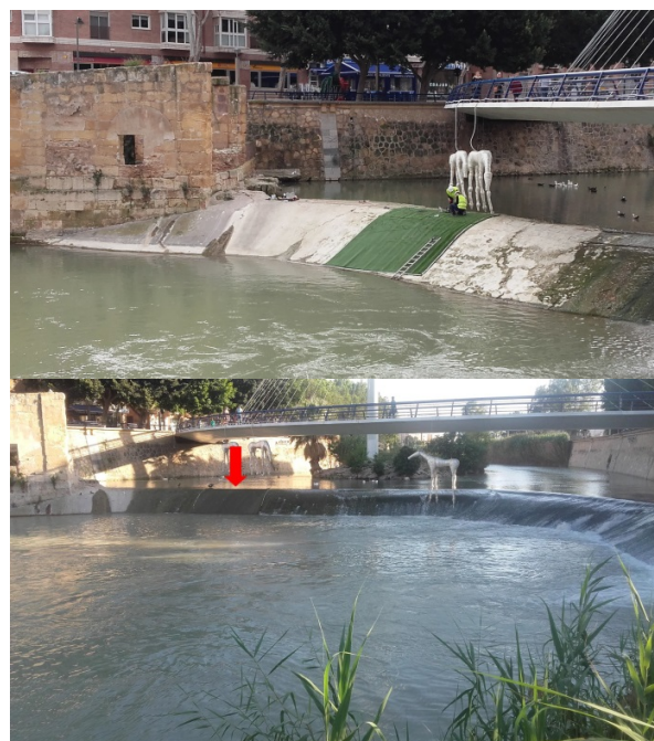
Figura 11. Trabajos para la instalación de la rampa para anguilas en el azud de Manterola (arriba). Abajo se puede observar la posición de la rampa parcialmente sumergida (flecha roja) en una imagen tomada meses después de su instalación.
